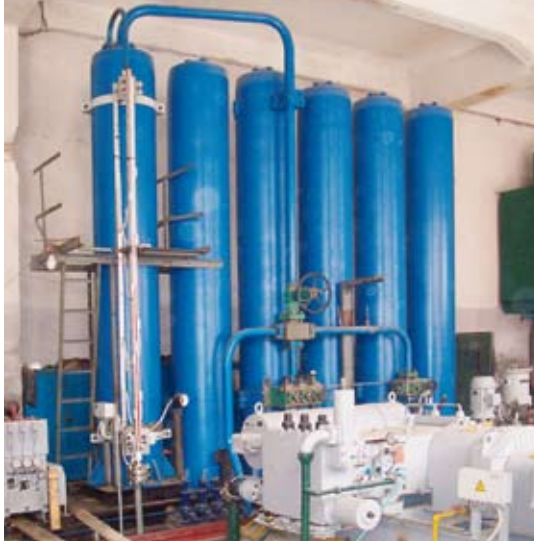
Akumulátorová stanice – HELWANT, Egypt
